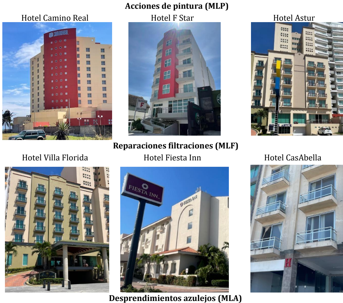
Figura 9 Casos de deterioro leve
