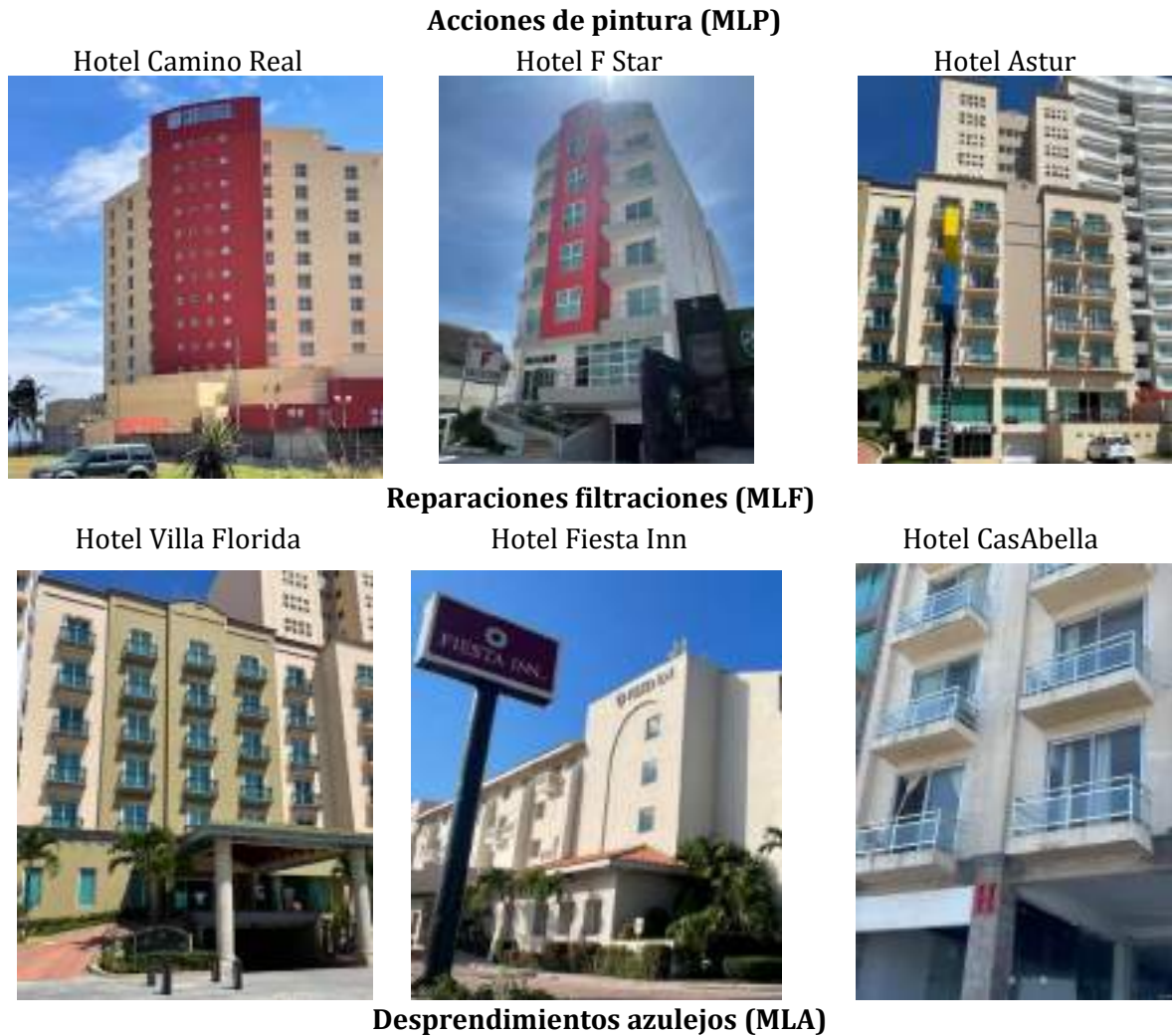
Figura 9 Casos de deterioro leve
